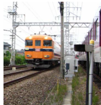
フラット検出装置
