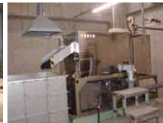
多重円盤式脱水機
