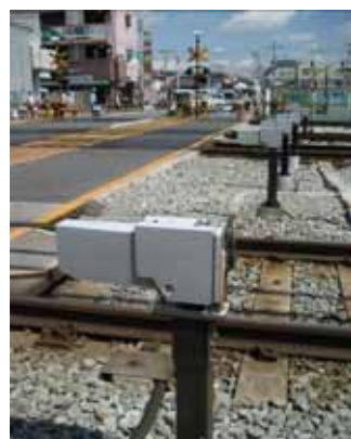
踏切障害物検知装置
