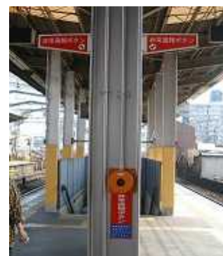
非常通報ボタン
