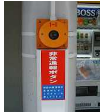
非常通報ボタン
