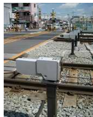
踏切障害物検知装置
