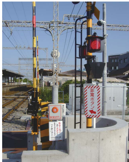
押ボタン式踏切支障報知装置
