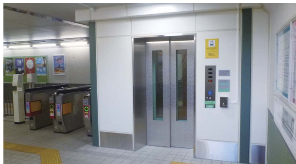
尼ヶ辻駅 エレベーター
