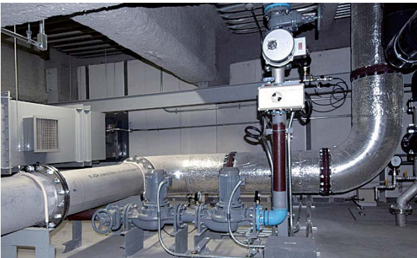
落水発電 (落水エネルギー回収装置)
