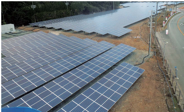
近鉄池の浦ソーラー発電所
