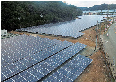
近鉄池の浦ソーラー発電所
