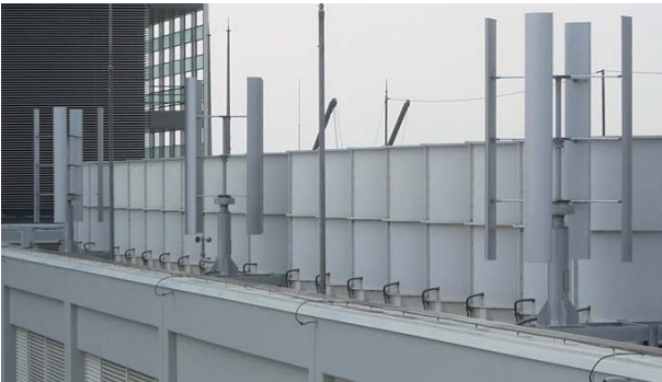
風力発電装置
