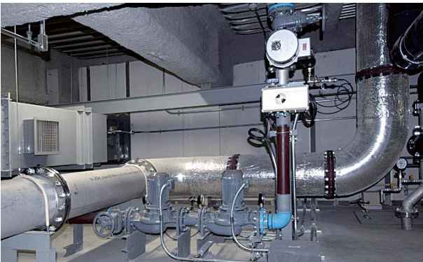
落水発電 (落水エネルギー回収装置)
