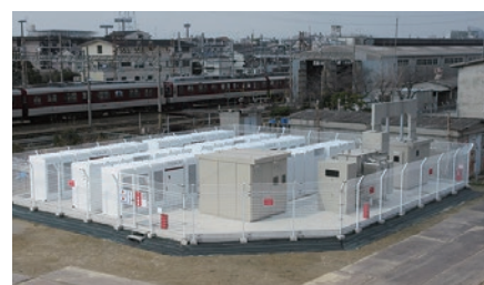
大規模蓄電池(東花園変電所)
