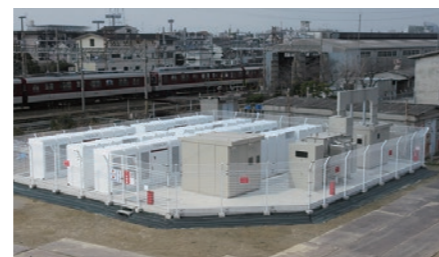
大規模蓄電池(東花園変電所)
