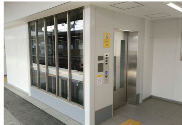
寺田駅 エレベーター
