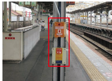
非常通報ボタン
