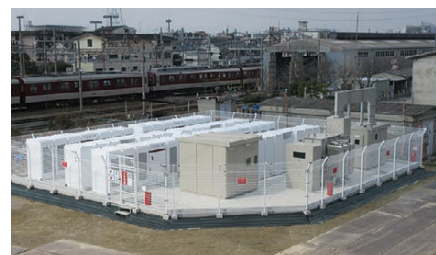
大規模蓄電池(東花園変電所)
