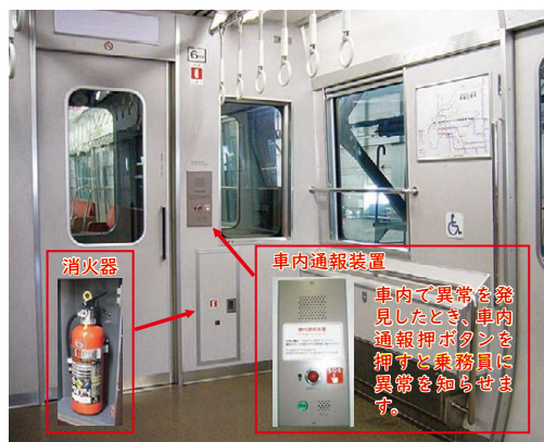
消火器と車内通報装置
