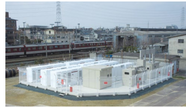
大規模蓄電池
