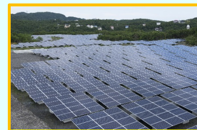
近鉄志摩スペイン村ソーラー発電所
